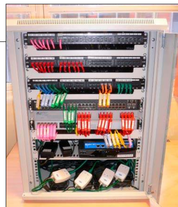
Verschnürt und Beschriftet: Die Cablebugs mit Etikett fassen mehrere Netzwerkkabel zu einem Strang zusammen und bieten auch noch Platz für Notizen.
